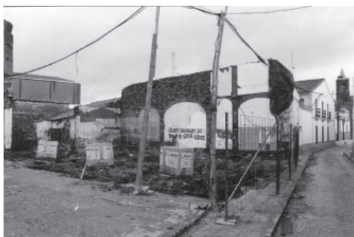
Fig. 11. Demolición de la Cámara Agraria de Monesterio en 2002. Se apreciaron restos romanos reutilizados así como el suelo de tierra pisada de la casa de José Gallego Paz
